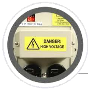
Terminales de salida y alimentación CA de Bornera
