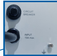
Breaker de circuito de protección
